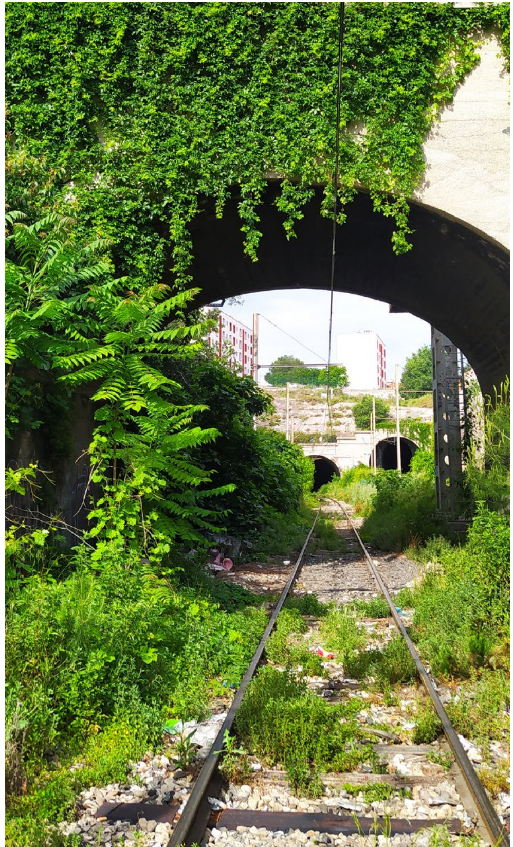
LE CANYON VÉGÉTAL Photo du site de projet 3 : l'entrée des tunnels ferroviaires (Europan)
